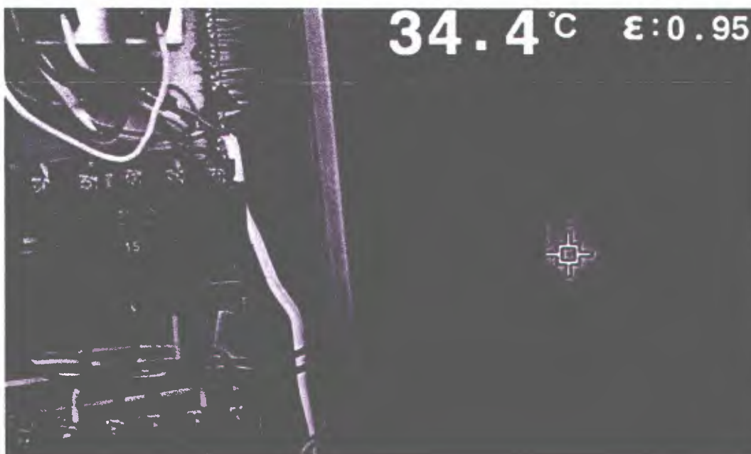
รูปที่ 16 แสดงภาพถ่ายความร้อนเบรกเกอร์ อาคาร9ชั้น1
