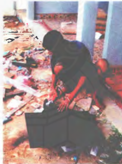
ภาพที่ 2 การแต่งกายที่ไม่ถูกระเบียบในงานก่อสร้าง
