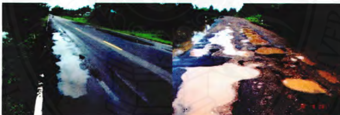
รูปที่ 2.1 ตัวอย่างความเสียหายของถนนที่เกิดขึ้นหลังน้ำลด
