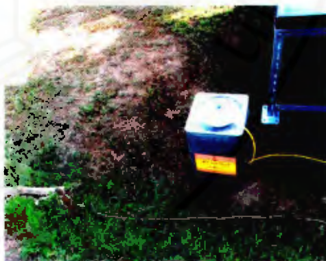
รูปที่ ก 6 ภาพถ่ายการติดตั้งไพรานอมิเตอร์
